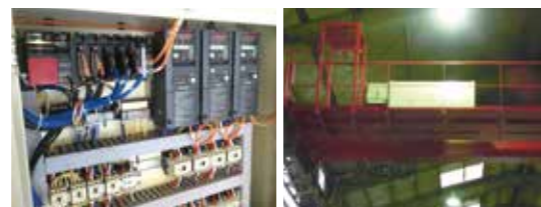
制御盤配線 クレーン制御盤 (設置後)
