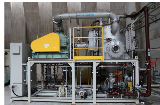
ヒートポンプ方式減圧濃縮装置
