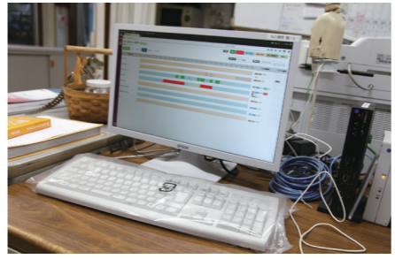
◀機械設備監視システム
