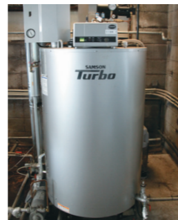
▲蒸気ボイラー(一式) ニーダー、スチーマーを稼働させるのに必要な蒸気を作るためのボイラー。
